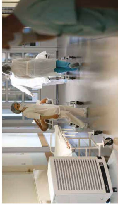
Urządzenie ELIXAIR E400 w szpitalu na korytarzu
